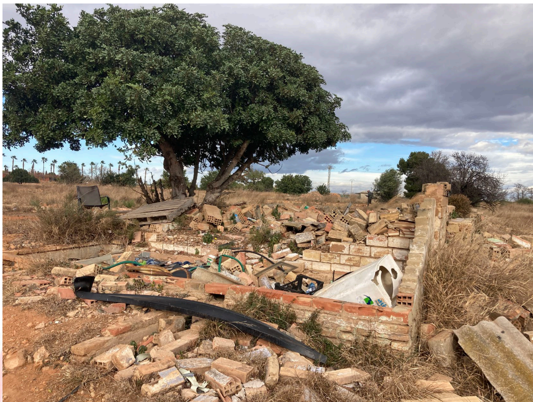
Figura 15.- Casa aislada, nº735. En estado de ruina.
