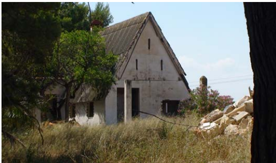
Foto 29: Zona 10. Inmueble abandonado y ruinoso.
