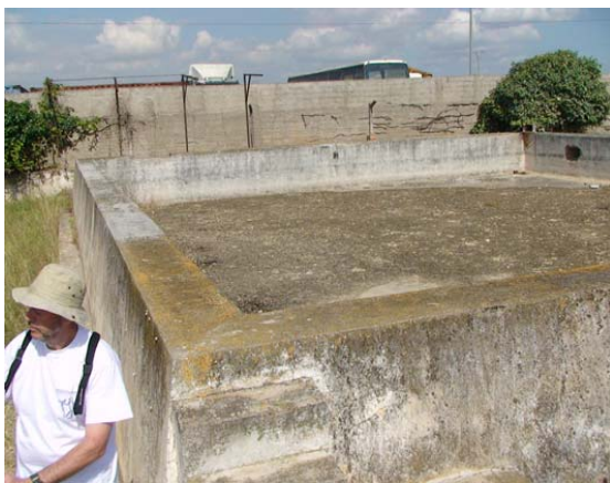
Foto 18: Zona 6, depósito de agua abandonado.
