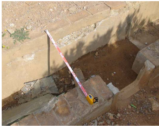
Foto 8: Detalle acequia abandonada.
