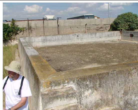
Foto 18: Zona 6, depósito de agua abandonado.
