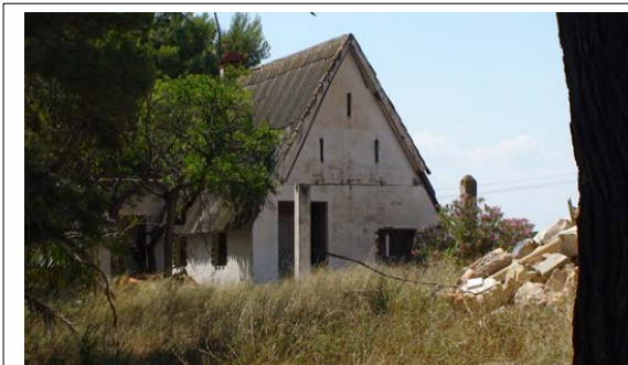
Foto 29: Zona 10. Inmueble abandonado y ruinoso.
